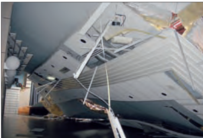
La toiture du centre socioculturel a cédé sous le poids de la neige, le 20 décembre dernier.
